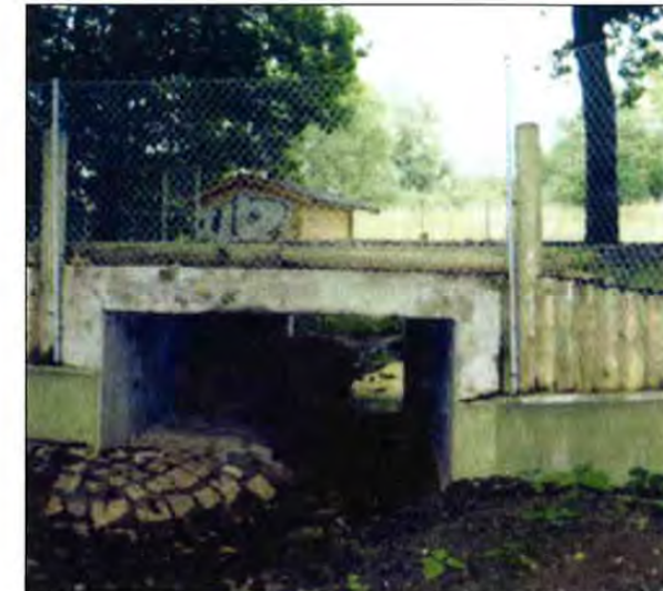
Bild 19: Fischotterdurchlass mit Graben
